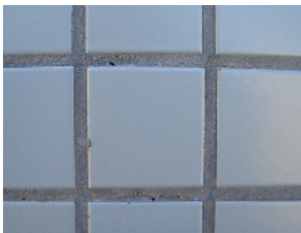
ピンホールの発生状況
