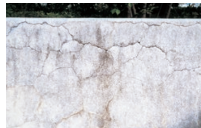
アルカリ骨材反応によるひび割れ状況
